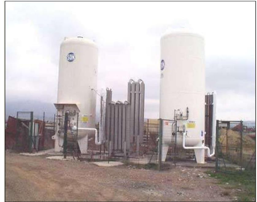
Serbatoi di ossigeno liquido
