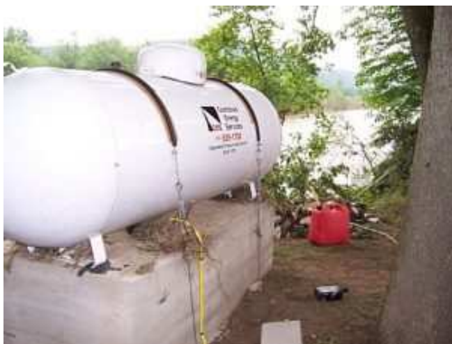
Ancoraggio di una cisterna in area alluvionale
