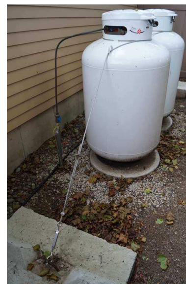
Ancoraggio di bombole di GPL
